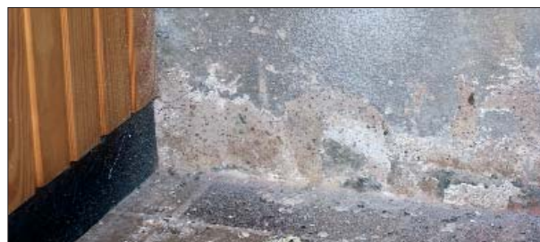
Schimmel an der Wand.
